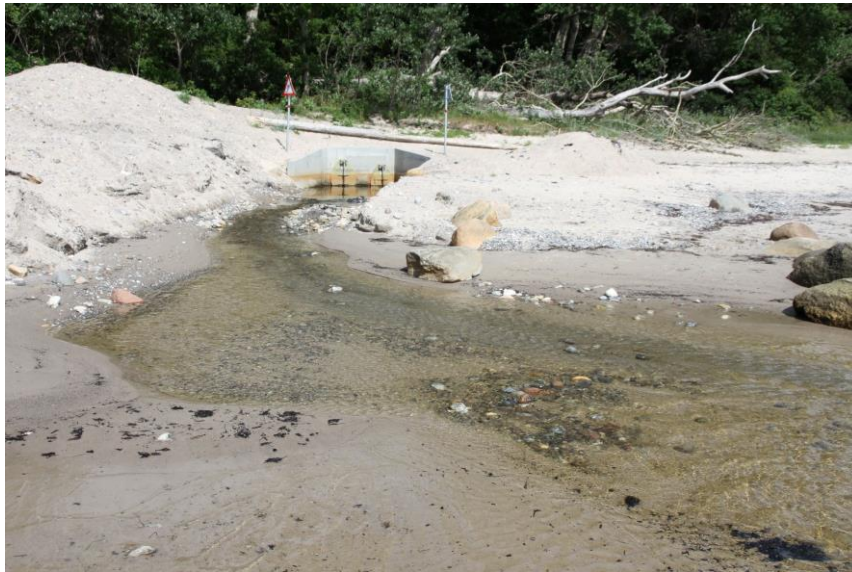
Foto 3 . Tunderupløbets udløb efter oprensning. I baggrunden højvandsslusen.
